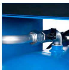
Bypass para desconexión del secador
