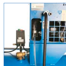
Secador preinstalado y conectado
