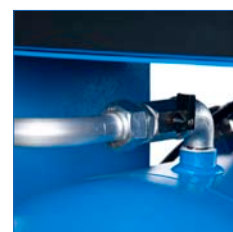
Bypass para desconexión del secador
