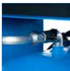
Bypass para desconexión del secador
